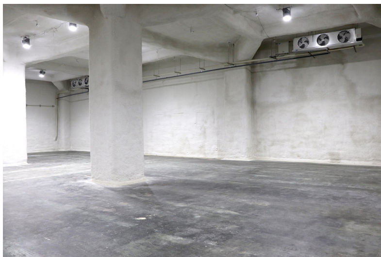
東運ウェアハウス内の冷蔵倉庫
